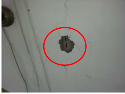
圖二 混凝土剝落
